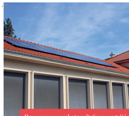
Des panneaux photovoltaïques ont été installés sur le toit de l'école Paul Lapie.
